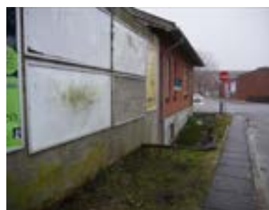
Adgangsvejene til stationsområdet er generelt smalle og fremstår nedslidte her vises adgangsvej fra Banegårdsgade..
