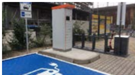
Synlig ladeinfrastruktur på markerede pladser
