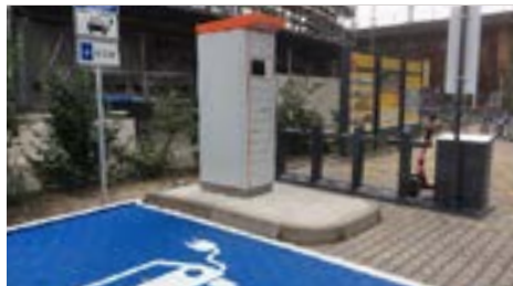
Synlig ladeinfrastruktur på markerede pladser
