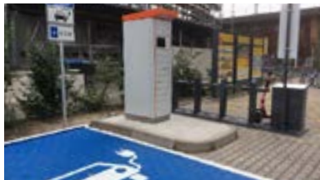
Synlig ladeinfrastruktur på markerede pladser
